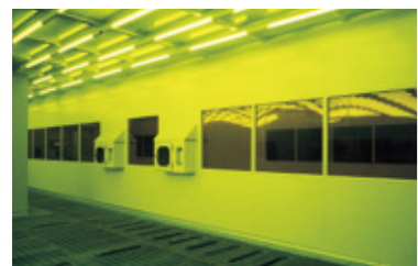
垂直層流方式クリーンルーム
