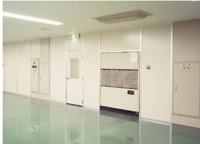
エアコンや設備機器を納めた壁面(PL)
