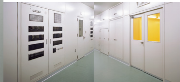
[CR-1] 制御盤を内蔵した壁パネル。
