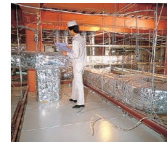
歩行用天井パネル。天井内設備のメンテナンスが容易。
