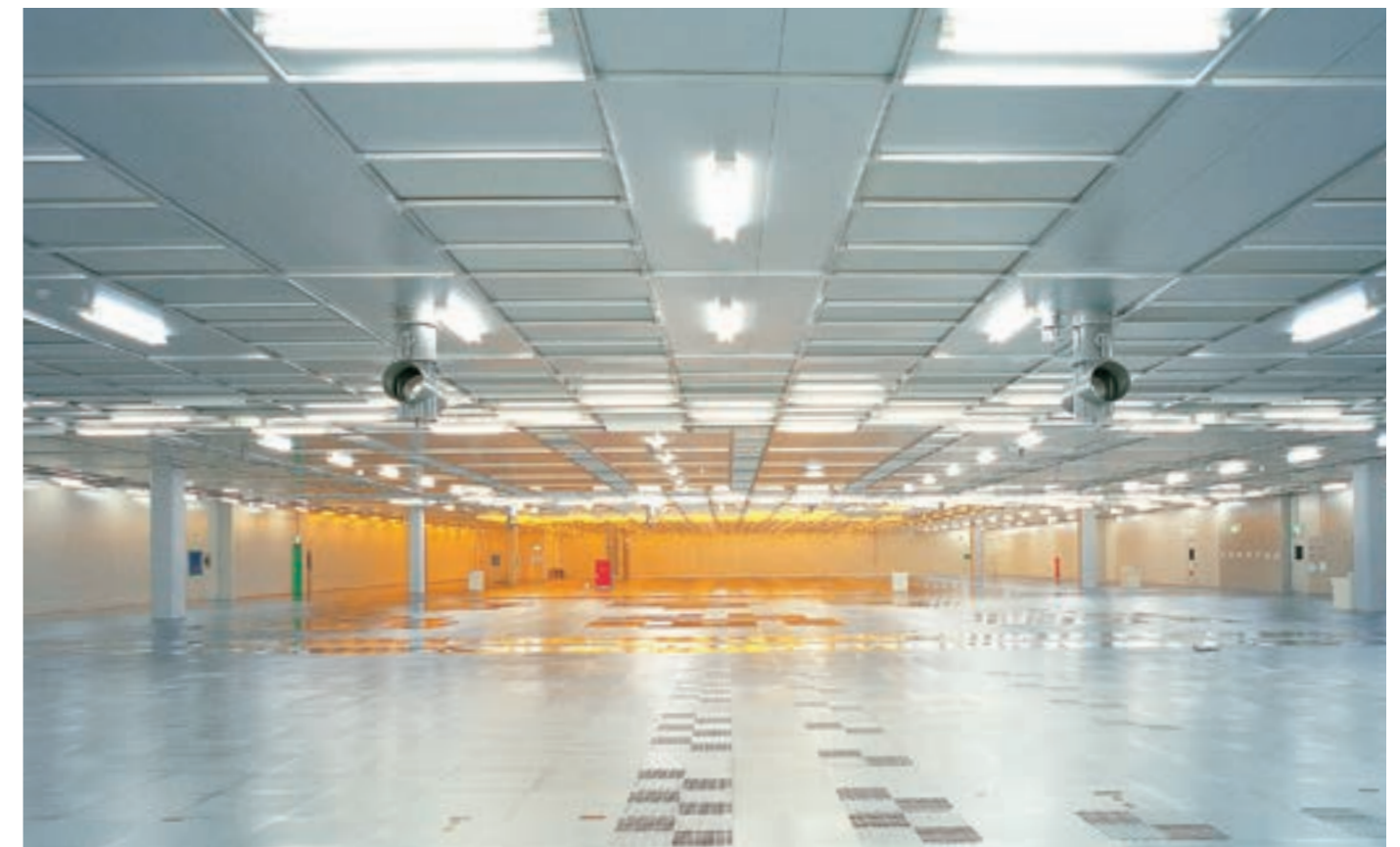
大空間のクリーンルームを構成する、天井、床、壁面。
