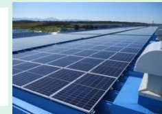
新設された第三工場の太陽光パネル
